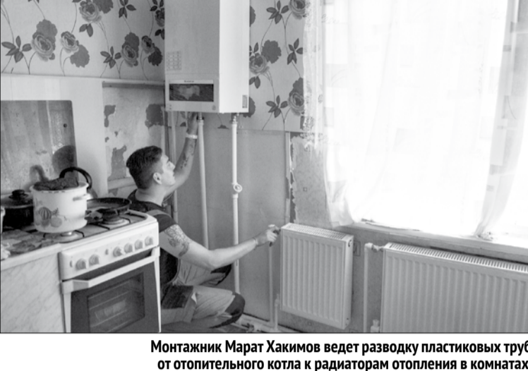
Монтажник Марат Хакимов ведёт разводку пластиковых труб от отопительного котла к радиаторам отопления в комнатах.
